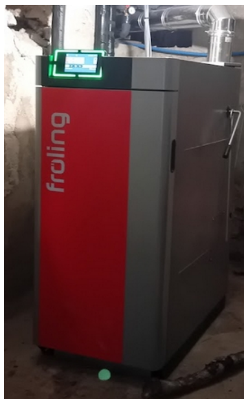
Une chaudière à bûches neuve
