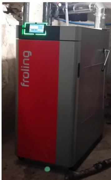
Une chaudière à bûches neuve
